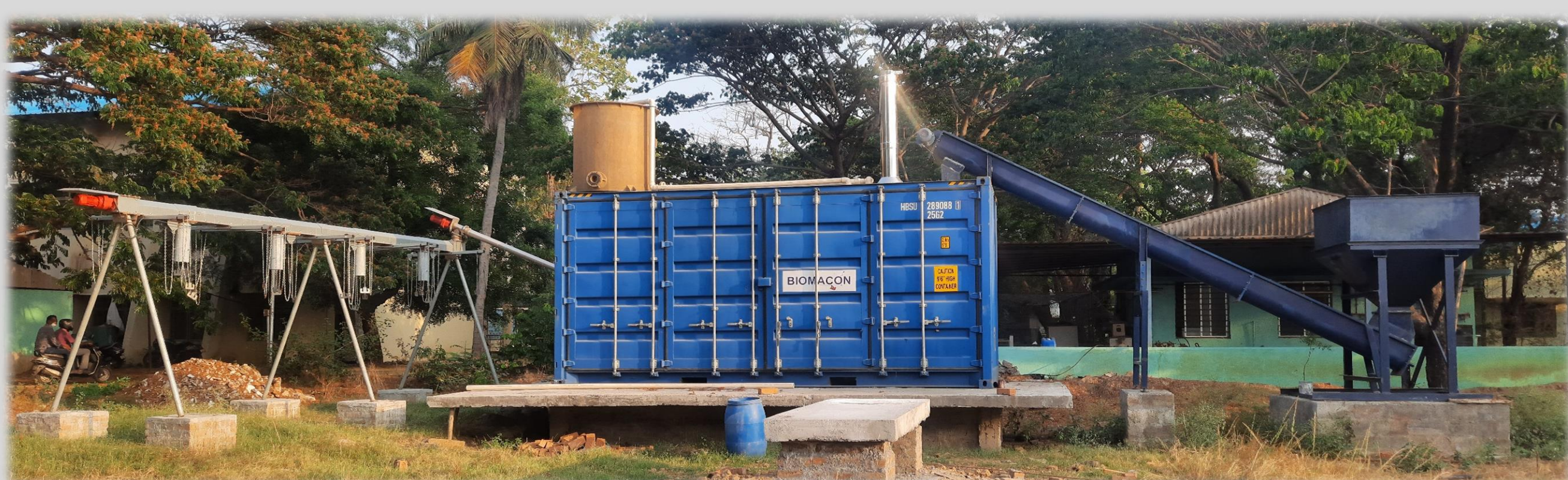
Demonstration eines Biomacron Pyrolyse-Konverters im technischen Maßstab
