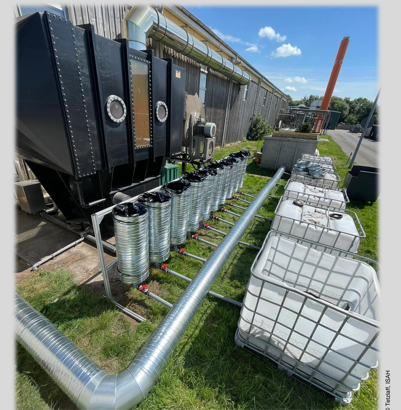
Biofilter zur Abluftreinigung/Methanoxidation
